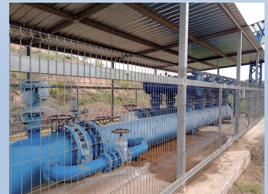
Estaciones de Filtrado
