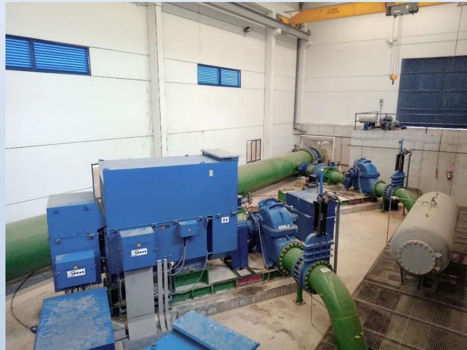
Estaciones de Bombeo
