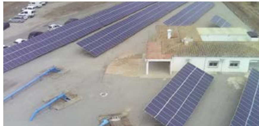
Bombeo Solar de alta potencia en el Pozo Lliries de la CR de Llíria (319 kWp de paneles fotovoltaicos instalados – Bomba sumergida de 300 CV).
